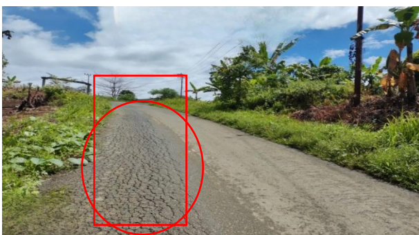
Gambar 5. Jenis kerusakan retak memanjang pada STA. 23+975
