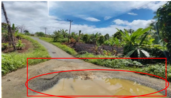
Gambar 4. Jenis kerusakan ambblas pada STA. 23+950 dan STA. 23+975
